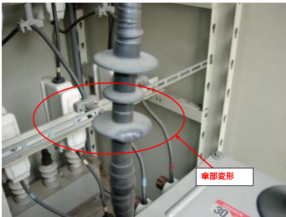
写真1 変形した屋内端末： 小林電気保安事務所殿ご提供
