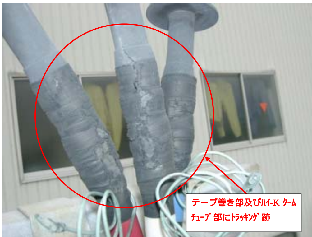
写真2 変形した屋外端末： 小林電気保安事務所殿ご提供
